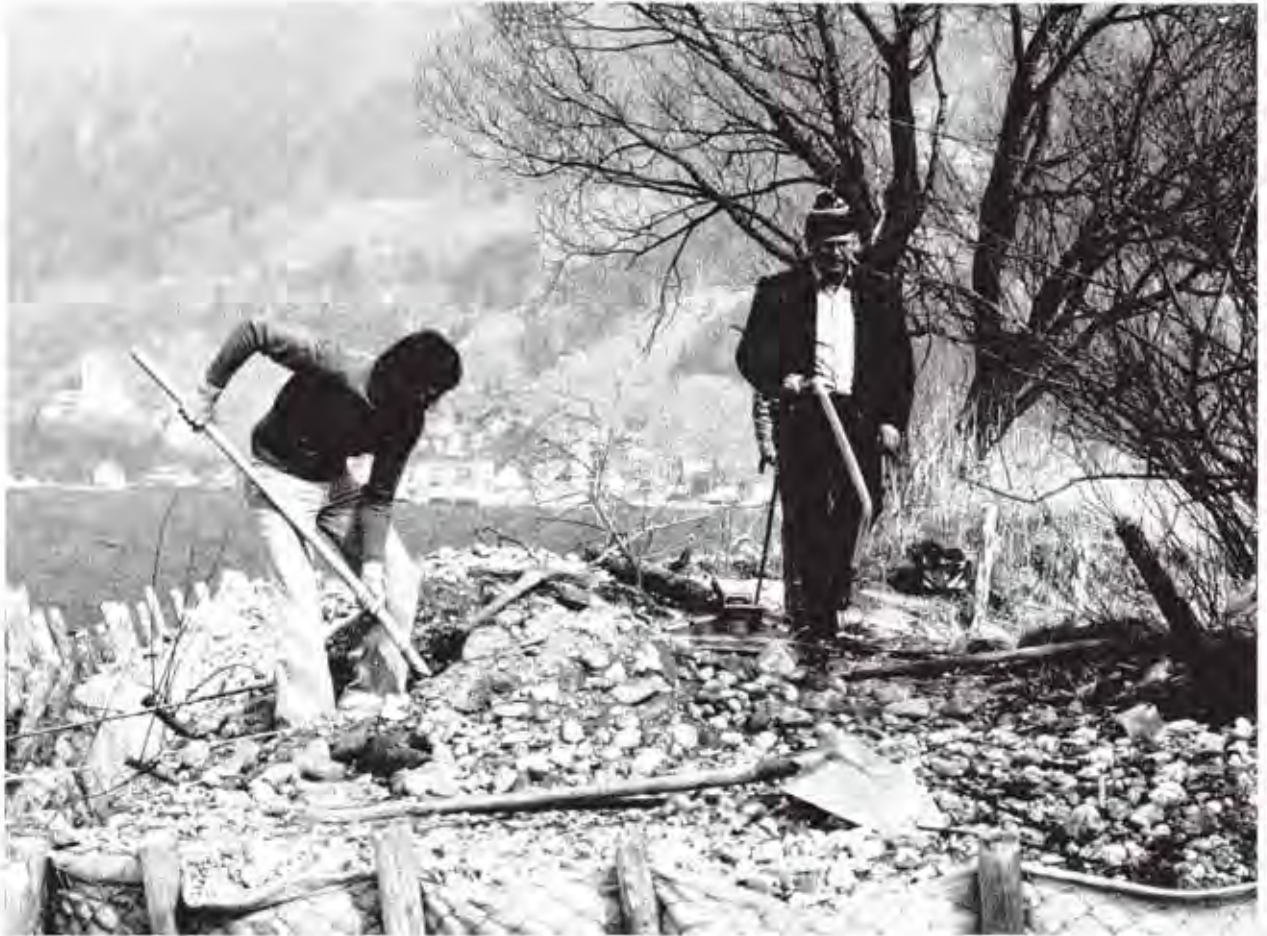
Abb. 4.7. In Fronarbeit wird der Schutzwall ständig ausgebessert und Schäden werden repariert
